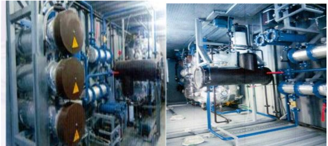
Şəkil 1.1.3. Emal qurğusunun görünüşü.
